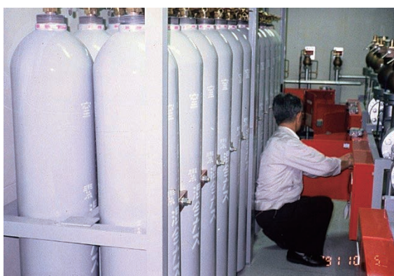
図3 倉庫内のハロンガスボンベ
