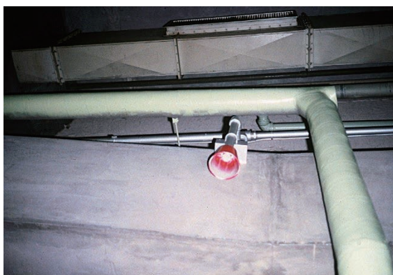
図4 駐車場内のハロンガス吹き出しノズル
