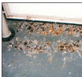
フンによる被害状況
