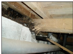
浴室土台の被害例
